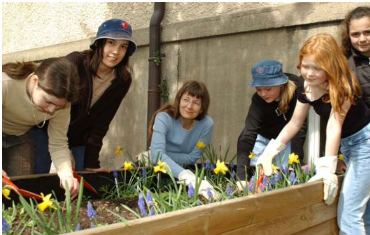
Aufbau eines Hochbeetes an der Scharrerschule in Nürnberg mit Mitarbeitern der Firma Novartis
